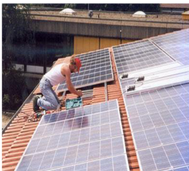
Obr.2.: Ilustrační foto PV systému (střešní instalace)
