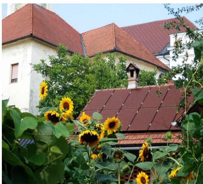
Obr.2.: Ilustrační foto PV systému (střešní instalace) s barevnými panely
